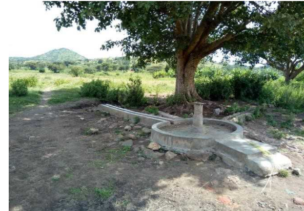
補修対象の、破損打ち抜き井戸
