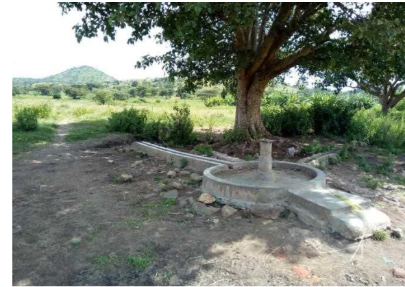
補修対象の、壊れた打ち抜き井戸
